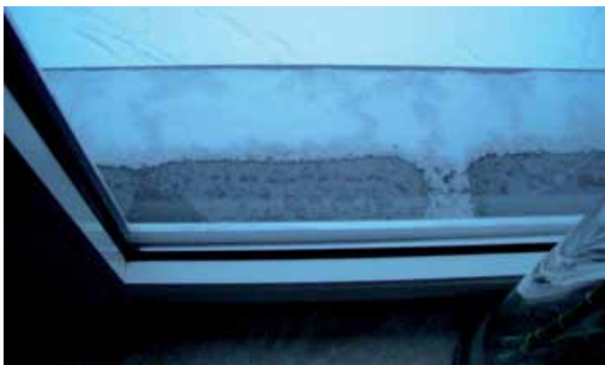
Wird die Dämmung unter der Fensterbank fehlerhaft angebracht, entsteht eine fatale Kältebrücke, die im Nutzungszustand zu Kondensat und Schimmel führen kann.
