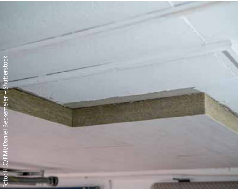
Die Dämmung der Kellerdecke ist eine sehr effiziente Einzelmaßnahme, die sich schnell bezahlt macht.
