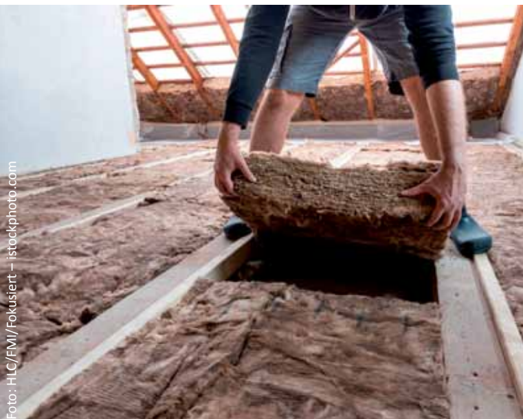
Die Dämmung des Dachbodens mit Mineralwolle, dazu gehören Glas- und Steinwolle, zählt mit wenig Aufwand zu den wirksamsten Einzelmaßnahmen am Haus, um wertvolle Energie einzusparen.
